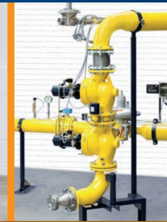
Erdgasregelstrecke für Trockner Natural gas control section for thermotechnical systems
